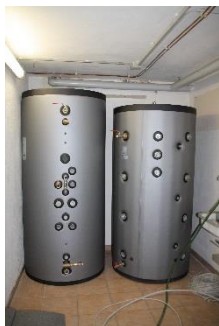
Abbildung 16 Installierte Wärmespeicher bei EFH Hagenbach (1.000 l / 800 l, PW)
