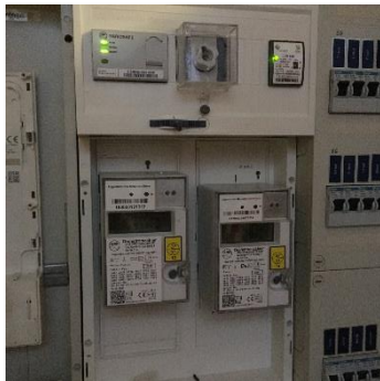
Abbildung 18 Schaltschrank EFH Hagenbach (PW)
